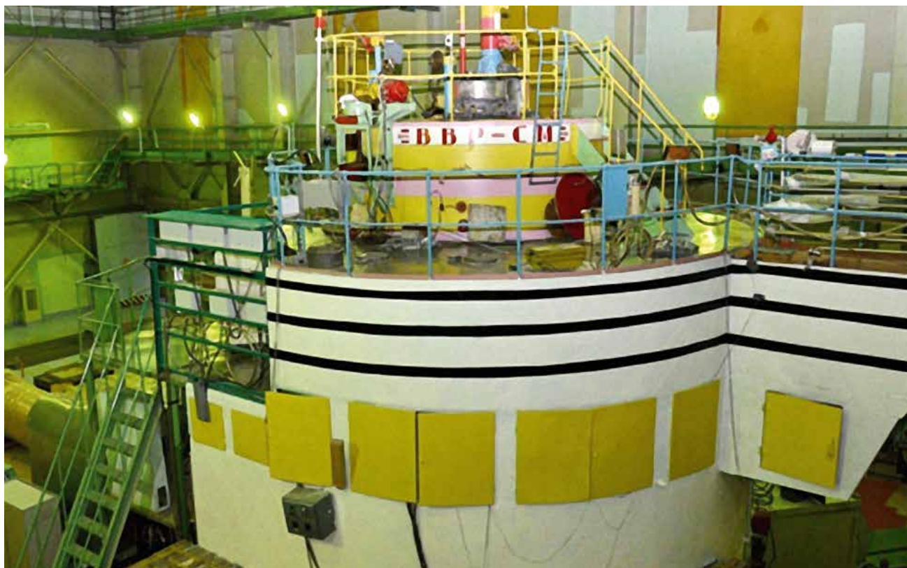
BBP-CM tadqiqot yadroviy reaktorining umumiy ko'rinishi
